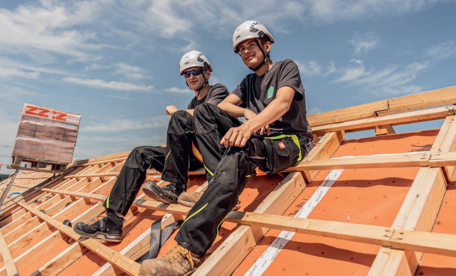
Les protagonistes Silvan Alder (à gauche), couvreur CFC, et Daniel Sommer, installateur solaire CFC.
