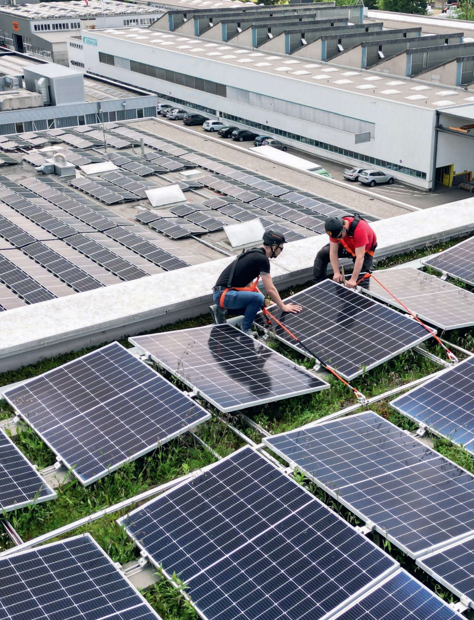
Auf den Dächern der Brauerei Locher wurde ein grosses Solarkraftwerk installiert. Für zuverlässige Sicherheit in diesem Bereich sorgt das System von INNOTECH.
