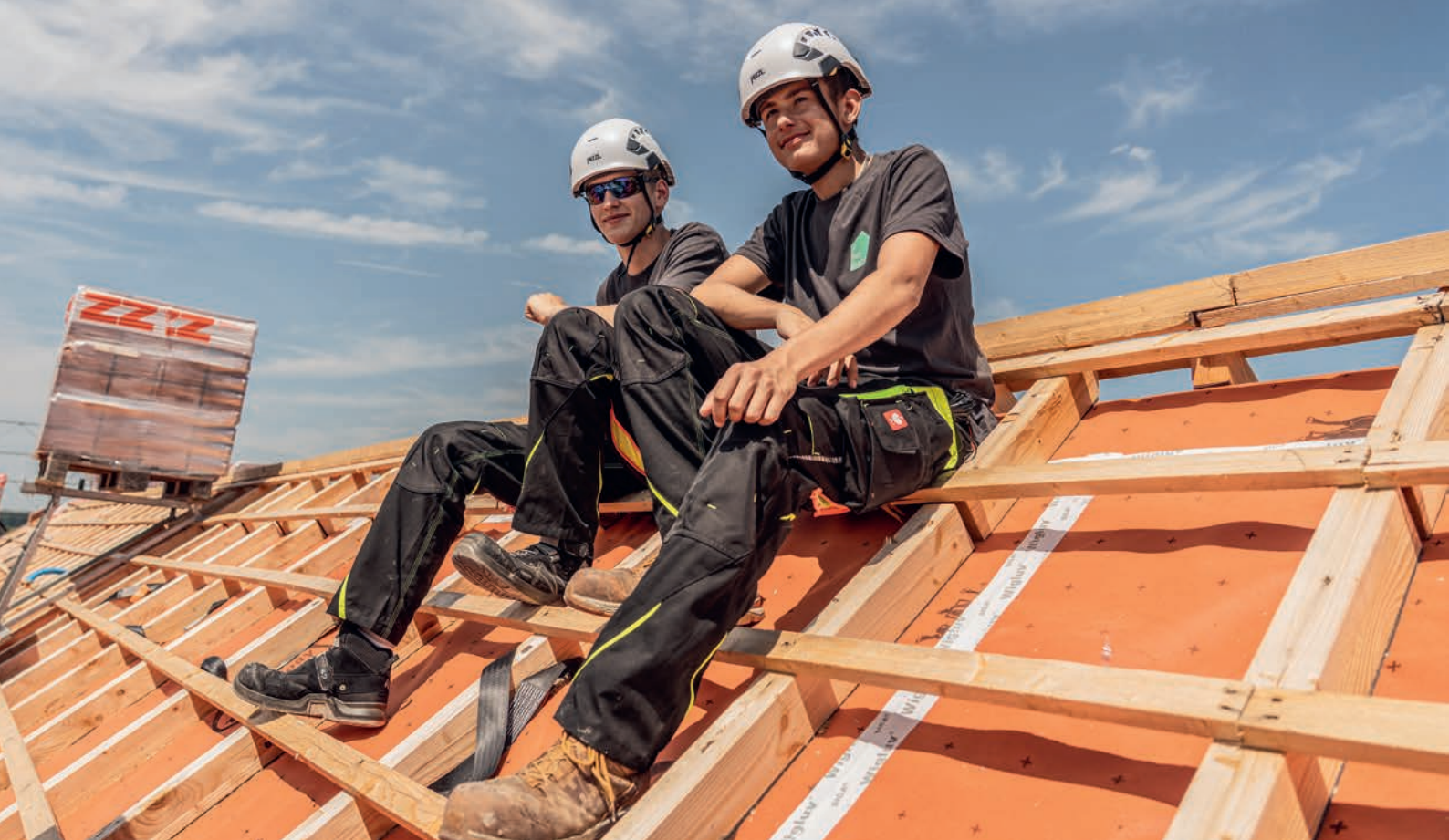
Die Protagonisten Silvan Alder (links), Dachdecker EFZ, und Daniel Sommer, Solarinstallateur EFZ.
