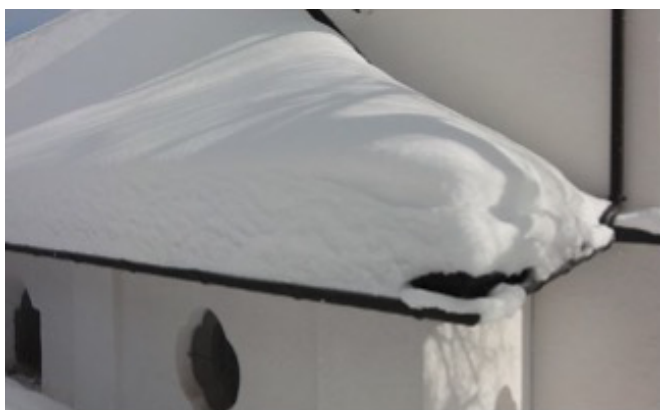
Abb. 9: Schnee- und Windlasten wirken auf die Tragkonstruktion, die Konterlatte sowie auf die Verlegeunterlage.
