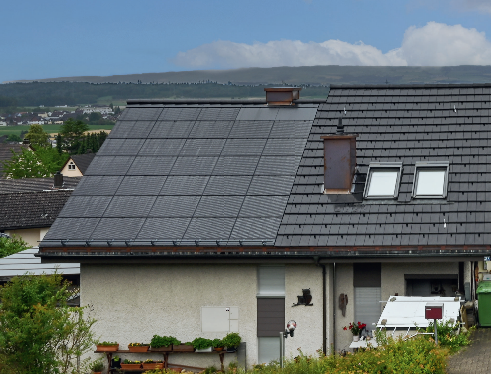
Solarenergie nach Mass: Die Indach-Anlage überzeugt durch passgenaue Dimensionierung und den sauberen Anschluss zum übrigen Dach.
