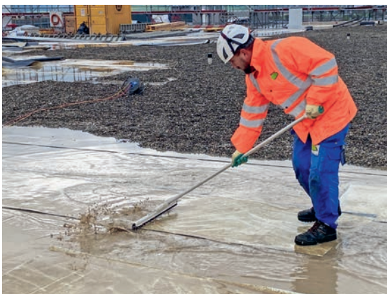
Kies entfernen, Material reinigen und aufrollen – so wird der Rückbau von Kunststoffabdichtungsbahnen organisiert.
