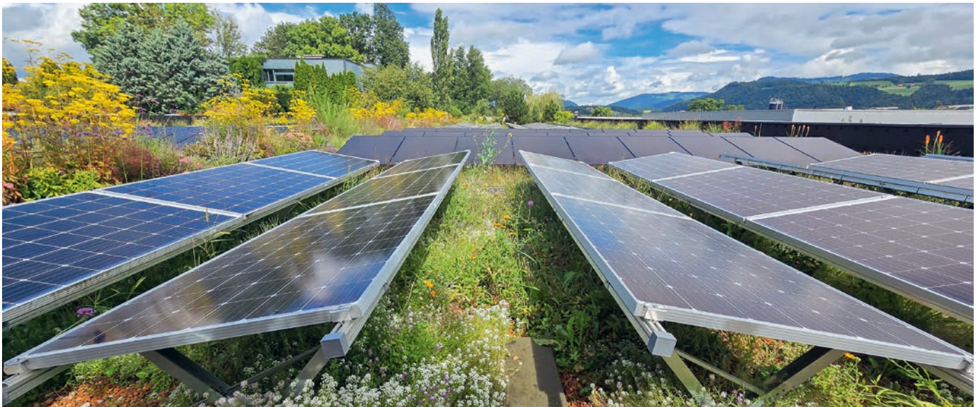
SuperEnergieGründächer verbinden Biodiversität, Wassermanagement und Energieproduktion sinnvoll miteinander.
