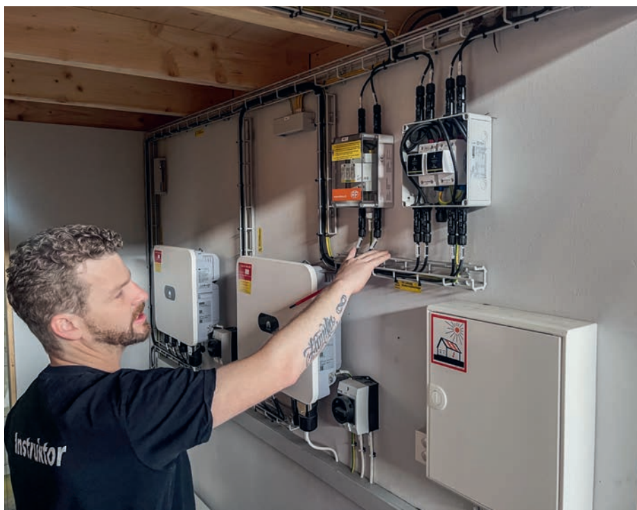
Ein zentrales Element des Kurses «Solarmonteur 2» bildet die DC-seitige Installation von Photovoltaik-Anlagen.
