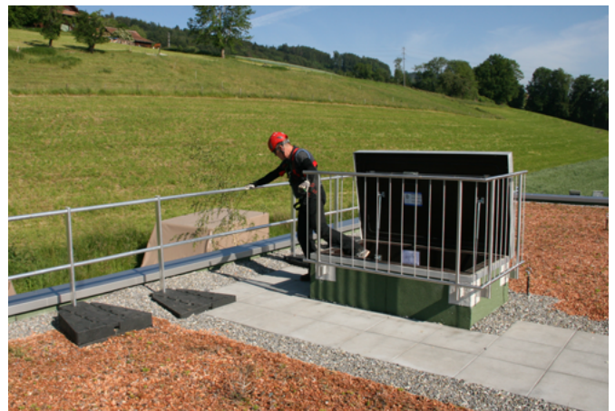
Abb. 38: Dachausstieg durch Seitenschutz aus dem Gefahrenbereich mit hoher Absturzgefahr gesichert. Optimal geplant würde der Dachausstieg in den inneren Gefahrenbereich führen
