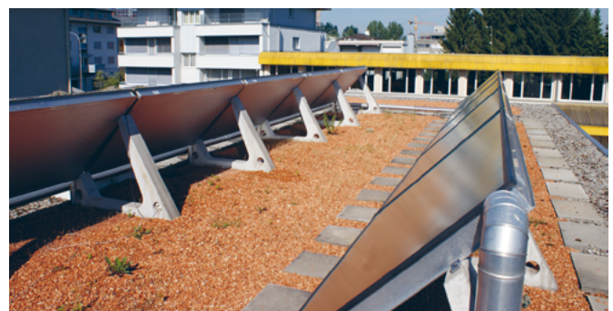
Sonnenkollektoren auf Betonaufständerung montiert. Gehwegplatten schützen das Abdichtungssystem bei Wartungs- und Unterhaltsarbeiten an den Kollektoren.
