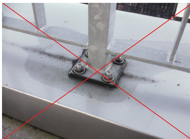
Abb. 7: Mangelhafte, unzulässige Ausführung
