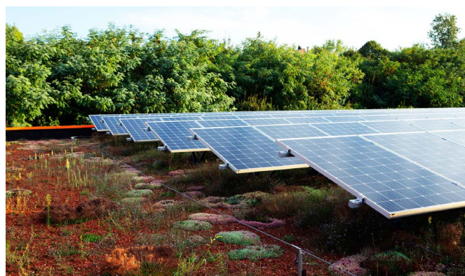
Solaranlage auf Flachdach
