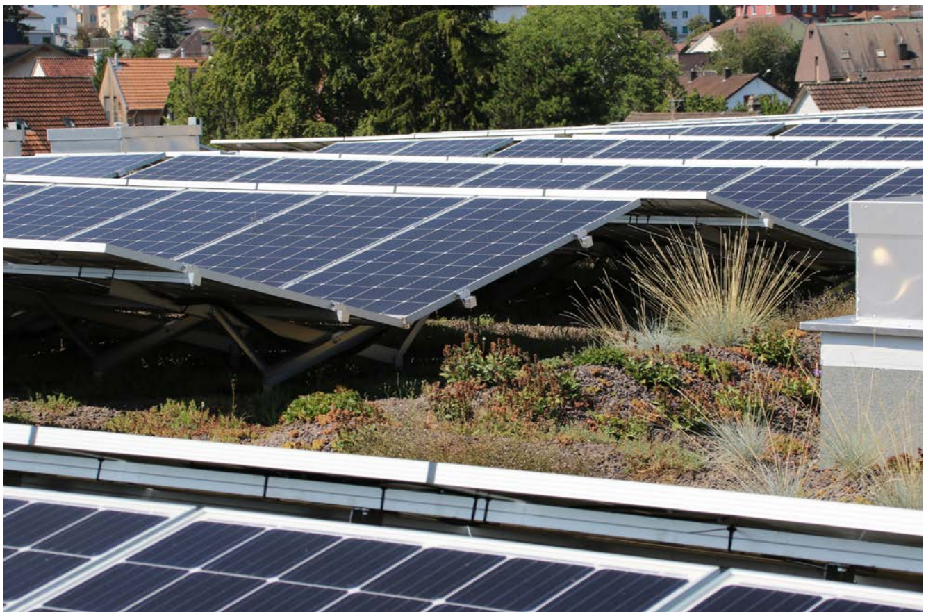
Abbildung 16: Gegen Osten/Westen ausgerichtete PV-Anlage mit modelliertem, unterschiedlich hohem Substrataufbau, Quelle: Zinco
