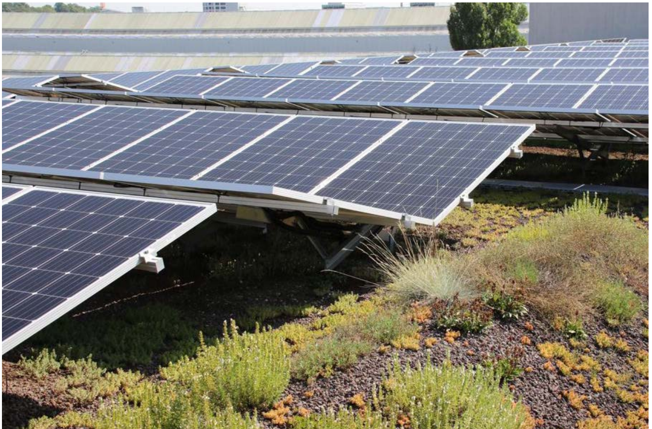
Abbildung 15: Gegen Osten/Westen ausgerichtete PV-Anlage mit minimalem Substrataufbau, Quelle: Zinco
