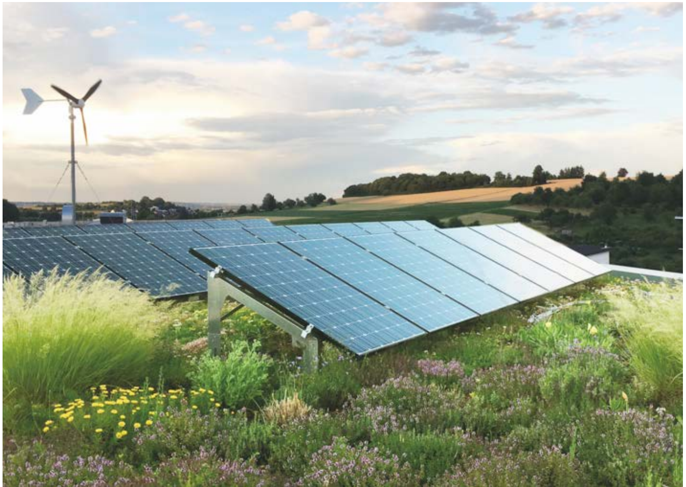
Abbildung 10: Kombination Intensiv-/Extensiv-Dachbegrünung neben PV-Anlage, Quelle: Zinco
