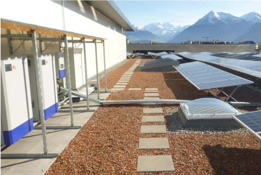
Abbildung 8: Kabelführung PV-Anlage zu Wechselrichter, Quelle: contec
