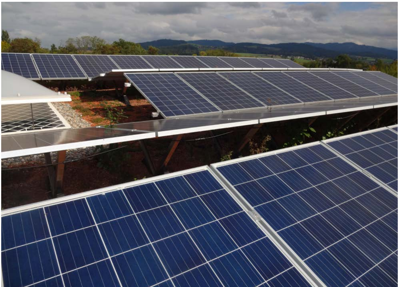
Abbildung 14: Gegen Osten/Westen ausgerichtete PV-Anlage mit modelliertem, unterschiedlich hohem Substrataufbau, Quelle: contec
