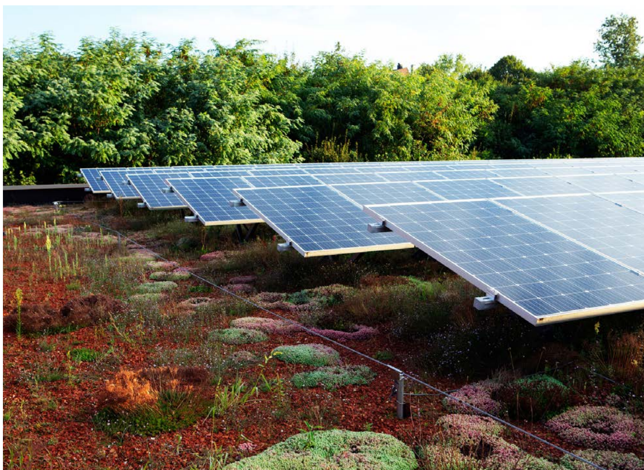
Abbildung 1: PV-Anlage kombiniert mit Extensivbegrünung, Quelle: contec
