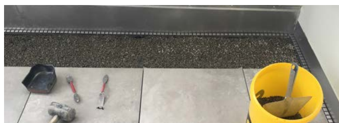
Fig. 5: pose des dalles en céramique / grès cérame sur une couche d'assise en gravier rond.
