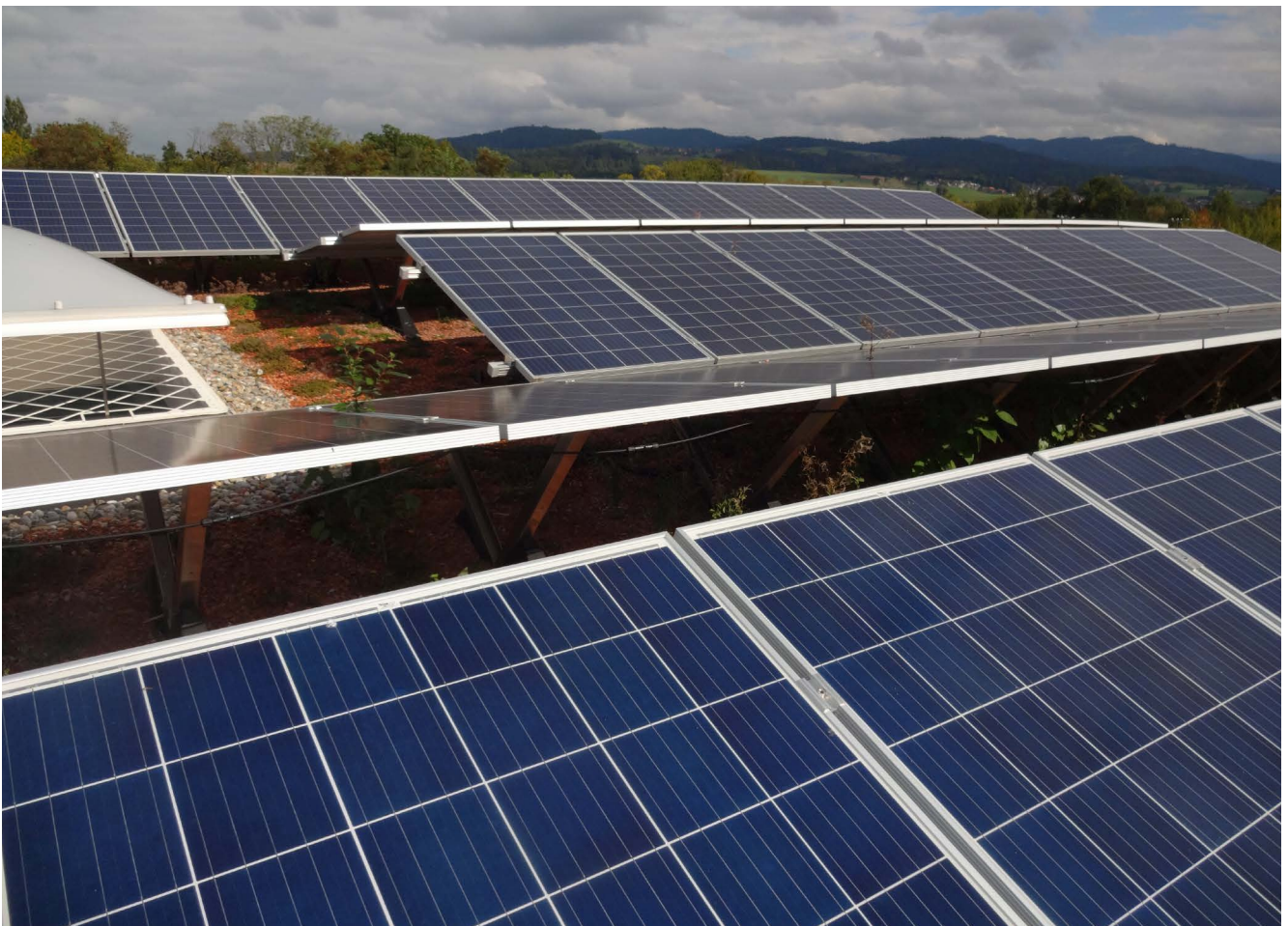
Figura 14: impianto fotovoltaico orientato a est/ovest con substrato minimo di diverse altezze, fonte: Contec
