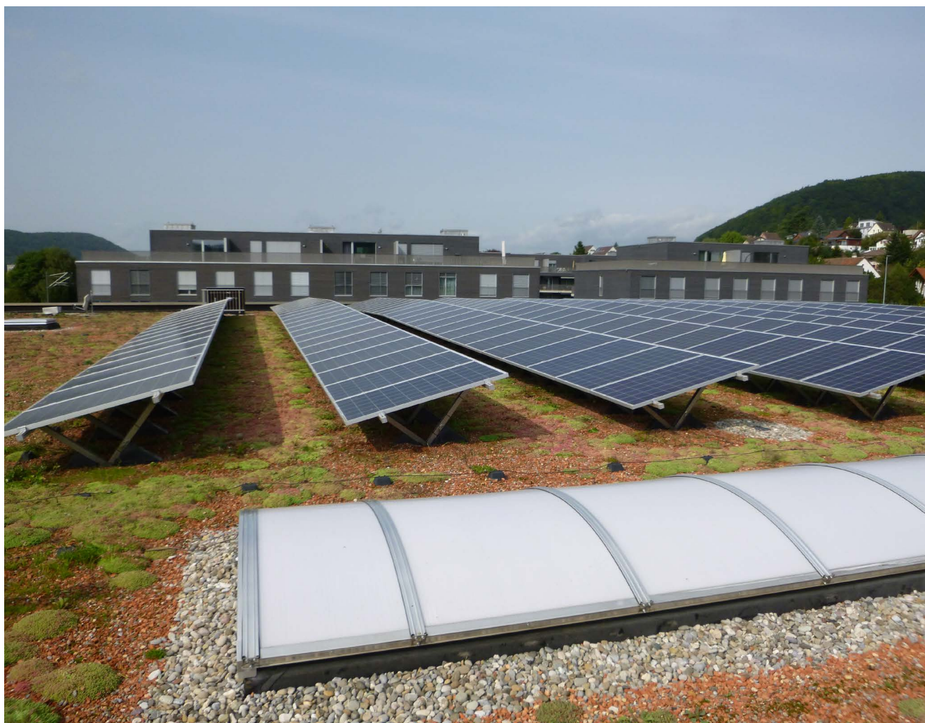
Figura 11: impianto fotovoltaico orientato a sud con substrato minimo, fonte: Contec
