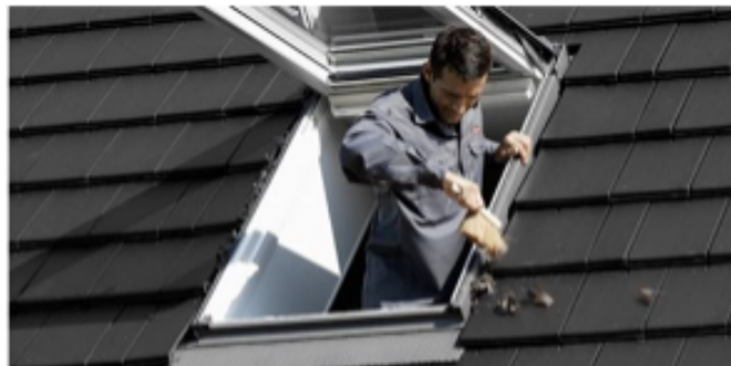
Fig. 2: Elevato rischio di infiltrazioni d'acqua nei raccordi a causa dell'accumulo di sporcizia.
