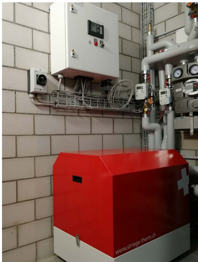
Etappe 2: KWL Komfortlüftung auch bei Altbaumodernisierung möglich.
