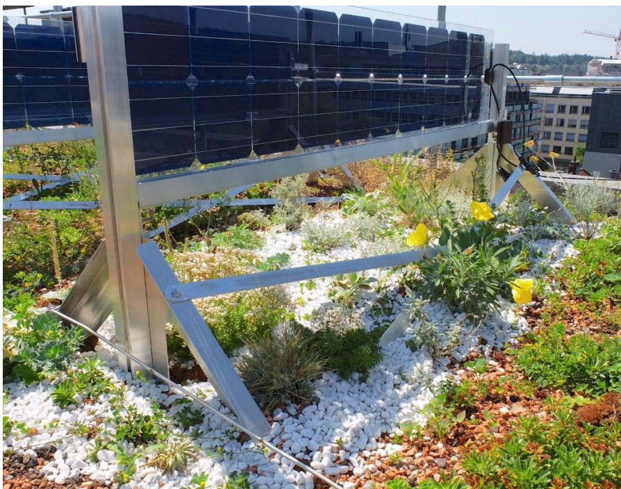
Figure 7: Installation PV avec modules bifaciaux sur le toit de la résidence pour personnes âgées Eichgut, Winterthour. Un sol clair avec des plantes à feuilles argentées, comme l'hélianthème et le thym, favorise la réflexion de la lumière du soleil et entraîne un gain de rendement de la production photovoltaïque. Source: Solarspar
