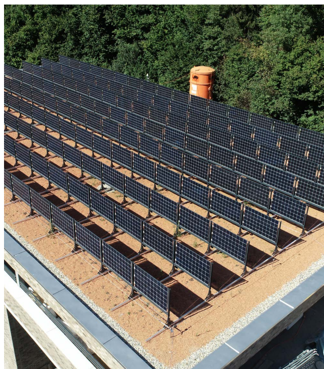
Figure 4: L'installation PV doit être installée à une distance suffisante du bord de la toiture ( \geq 60 cm), source: reech gmbh
