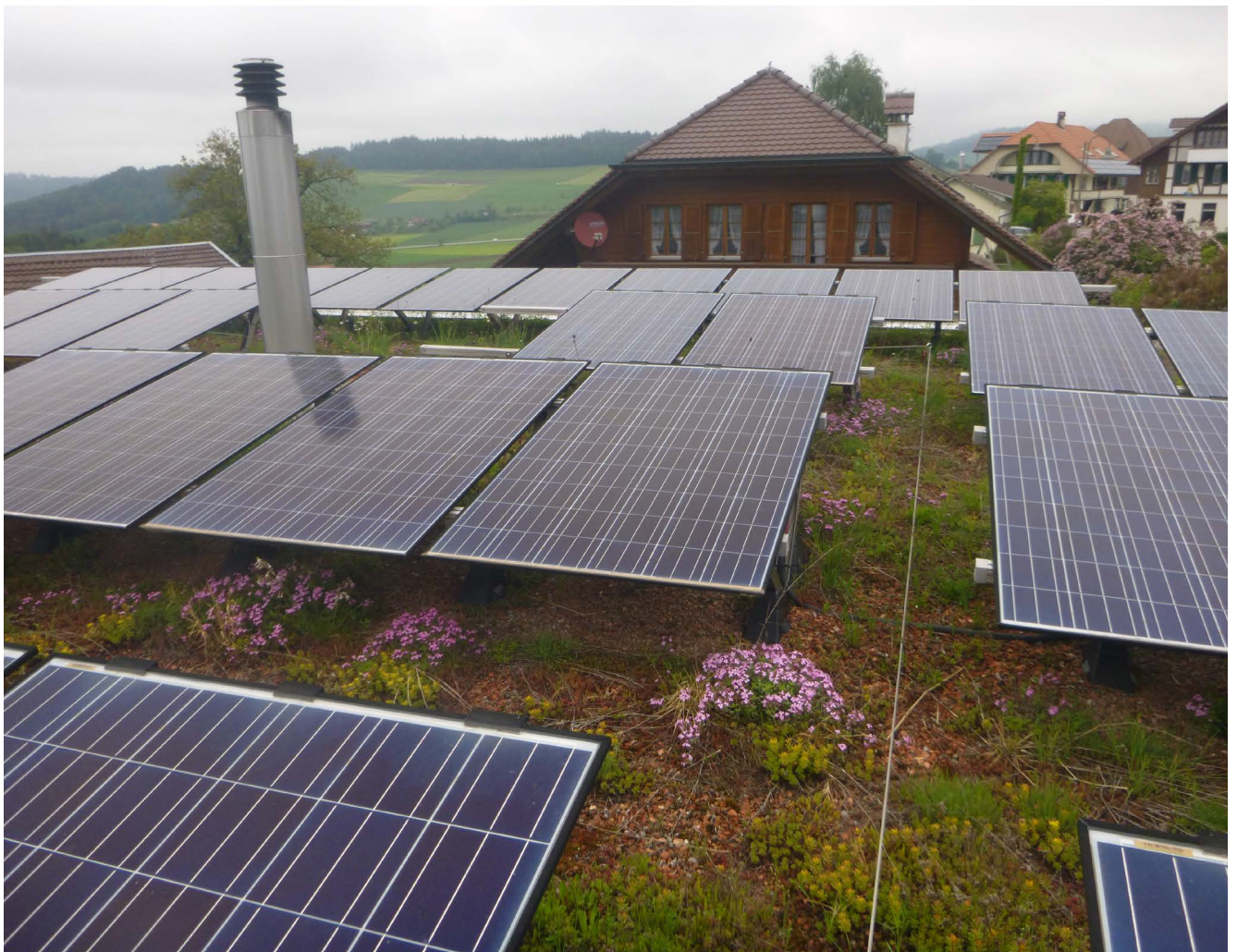
Figure 12: Installation PV orientée au sud avec une structure de substrat modelée de hauteur différente, source: Contec
